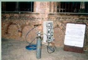
COMUNE DI PADOVA PROVE PRESSIOMETRICHE SU STRUTTURA MURARIA PADOVA - PALAZZO DELLA RAGIONE
