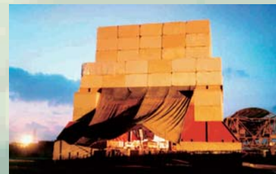
TRENO ALTA VELOCITÀ TRATTA ROMA-NAPOLI STRUTTURA DI CONTRASTO UTILIZZATA PER PROVE DI CARICO SU TRAVI DA PONTE
