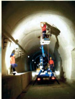
MONITORAGGIO FESSURIMETRICO DI UNA GALLERIA DELLA CIRCUMVESUVIANA DI NAPOLI
