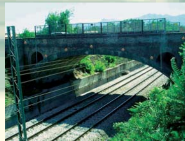
RFI S.P.A. - MONITORAGGIO PIANO ALTIMETRICO DI UN VIADOTTO DELLA LINEA FERROVIARIA ROMA - NAPOLI
