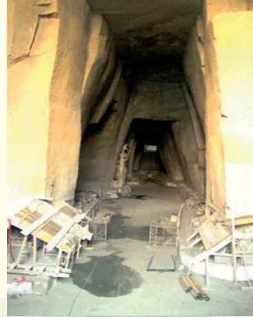
COMUNE DI NAPOLI - SERVIZIO DIFESA SUOLO MONITORAGGIO STRUTTURALE DEL RETICOLO CAVEALE "OSSARIO DELLE FONTANELLE" DI NAPOLI
